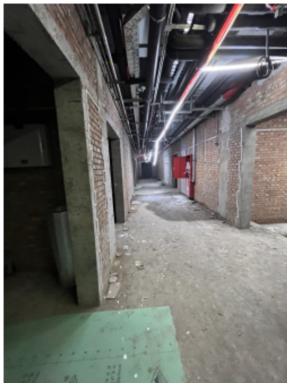
拟建核素影像区内部
